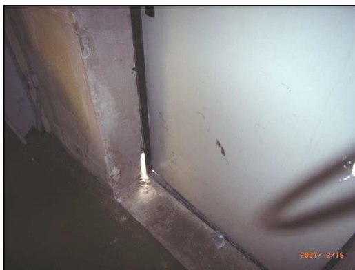
Abb. 12: Nicht dicht schließende Tür: Eintrittspforte für Ratten.
