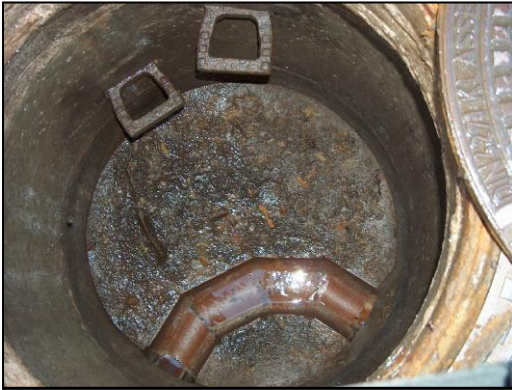
Abb. 9: Trittsiegel von Ratten im Kontrollschacht.
